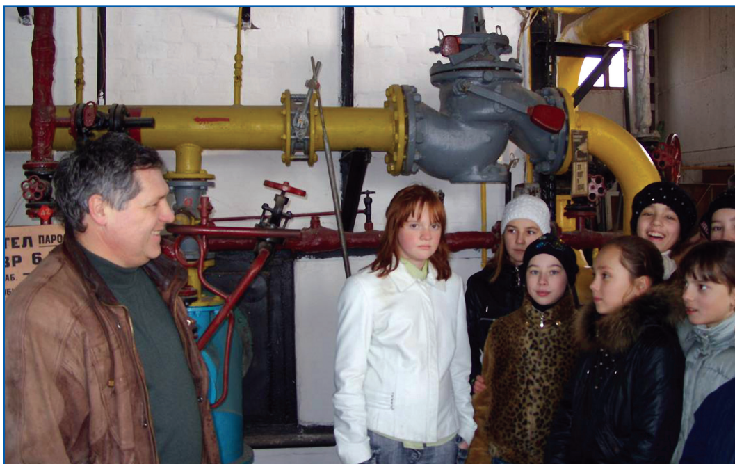
Екскурсія на котельню Євпаторійського філіалу «Кримтеплокомуненерго». Школа №12, м. Євпаторія.
