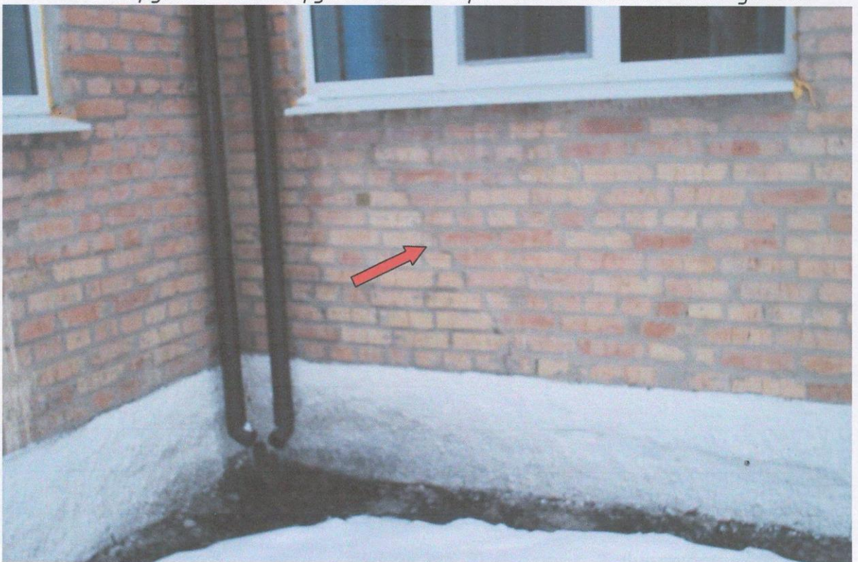
Фото А.29 – Тріщини в цегляній стіні по осі 10 біля осі Е внаслідок нерівномірних осадок ґрунтів основи фундаментів через систематичне замочування
