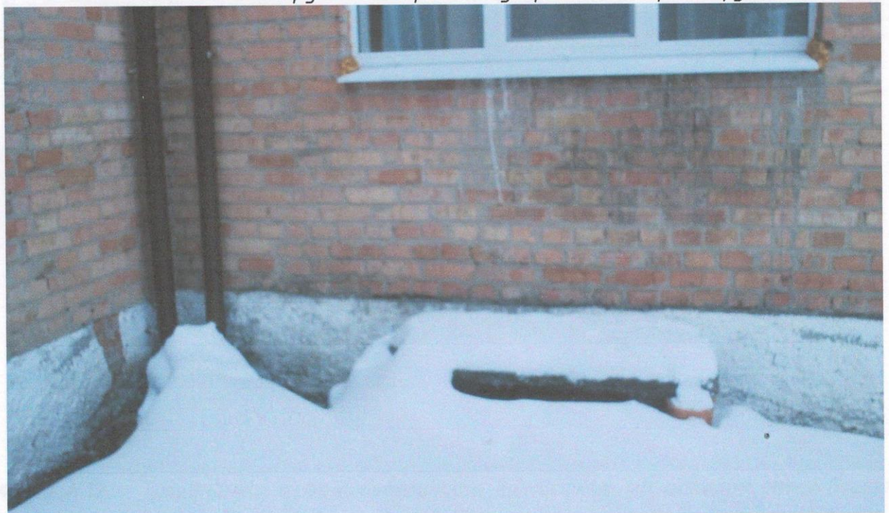
Фото А.10 – Тріщини між асфальтобетонною відмосткою та цоколем стіни в осях 10-В, просідання відмостки в результаті замочування через недостатній виліт водостічних труб та неправильну організацію рельєфу
