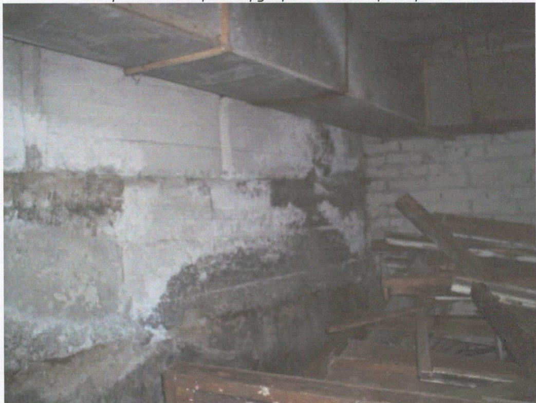
Фото А.15 – Систематичне замочування стін підвалу по осі И через тріщини між асфальтобетонною відмосткою та цоколем стіни та неправильну організацію рельєфу прилеглої території
