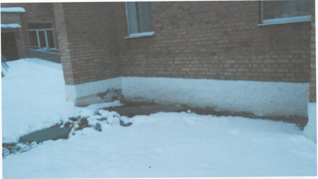
Фото А.11 – Тріщини між асфальтобетонною відмосткою та цоколем стіни по осі 8 в осях А-Б, просідання відмостки в результаті замочування через неправильну організацію рельєфу
