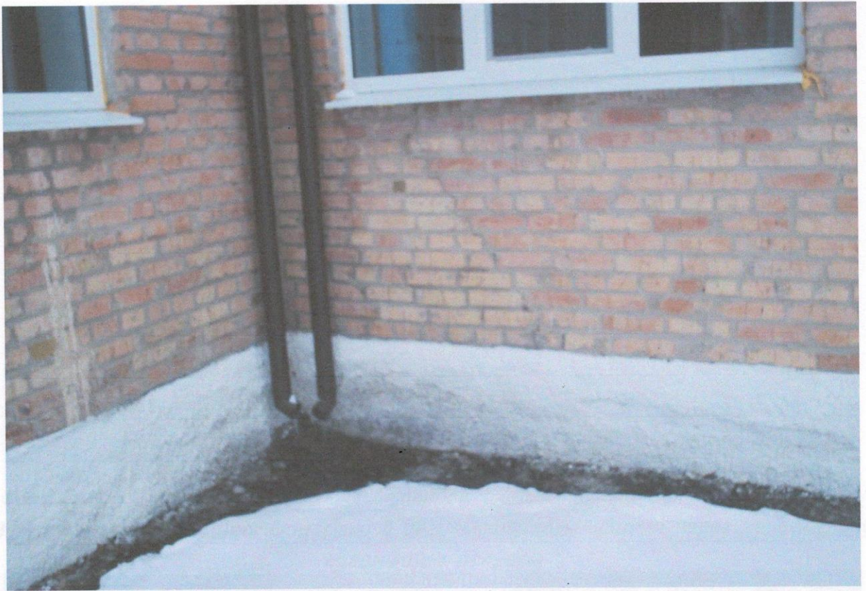
Фото А.9 – Тріщини між асфальтобетонною відмосткою та цоколем стіни в осях 10-Е, просідання відмостки в результаті замочування через недостатній виліт водостічних труб та неправильну організацію рельєфу
