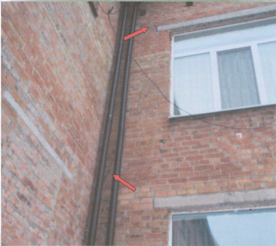
Фото А.25 – Тріщини в цегляній стіні по осі В біля осі 10 внаслідок нерівномірних осадок ґрунтів основи фундаментів через систематичне замочування
