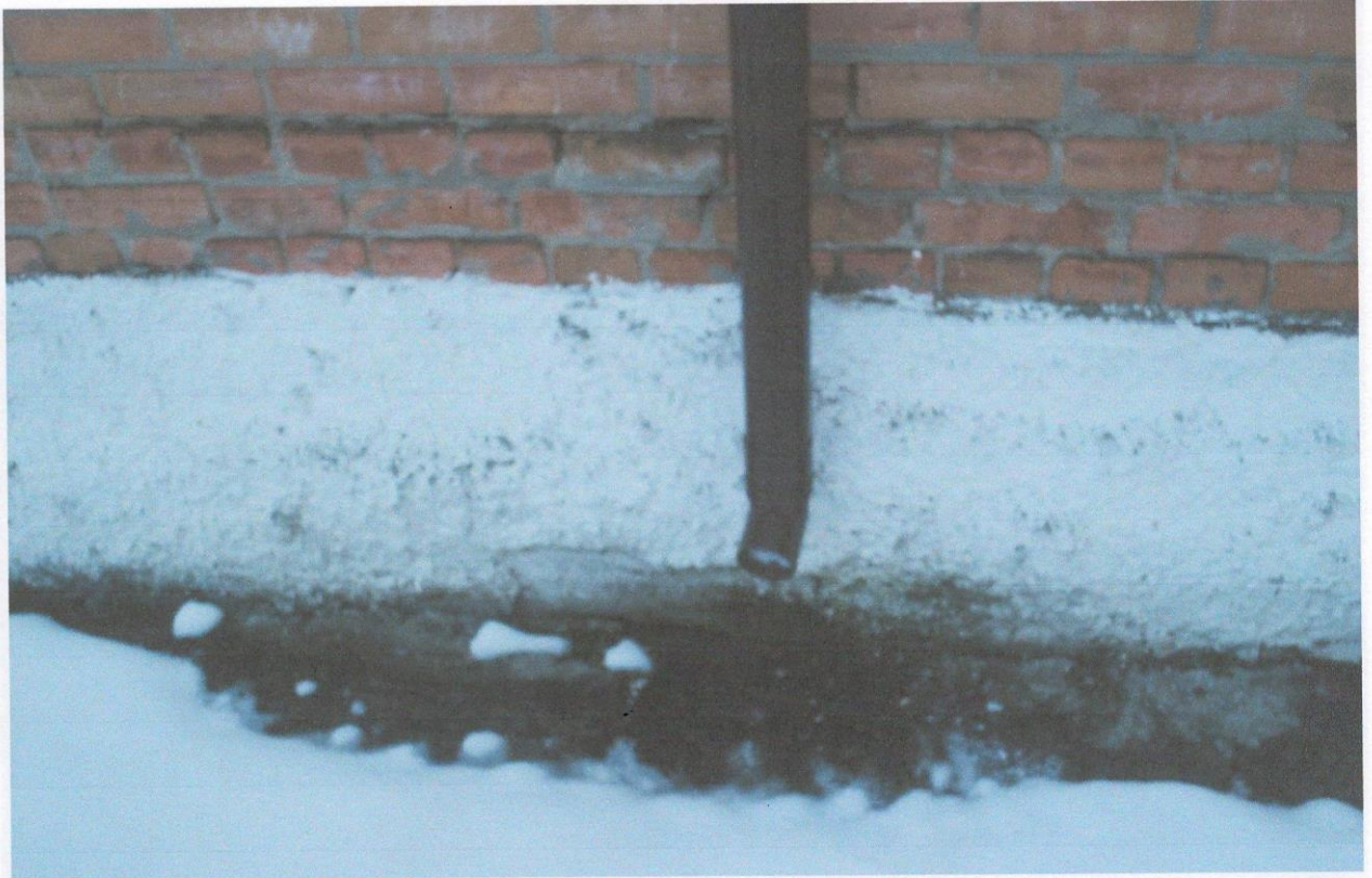
Фото А.2 – Тріщини між асфальтобетонною відмосткою та цоколем стіни по осі Г в осях 18-15, просідання відмостки в результаті замочування через недостатній виліт водостічних труб та неправильну організацію рельєфу
