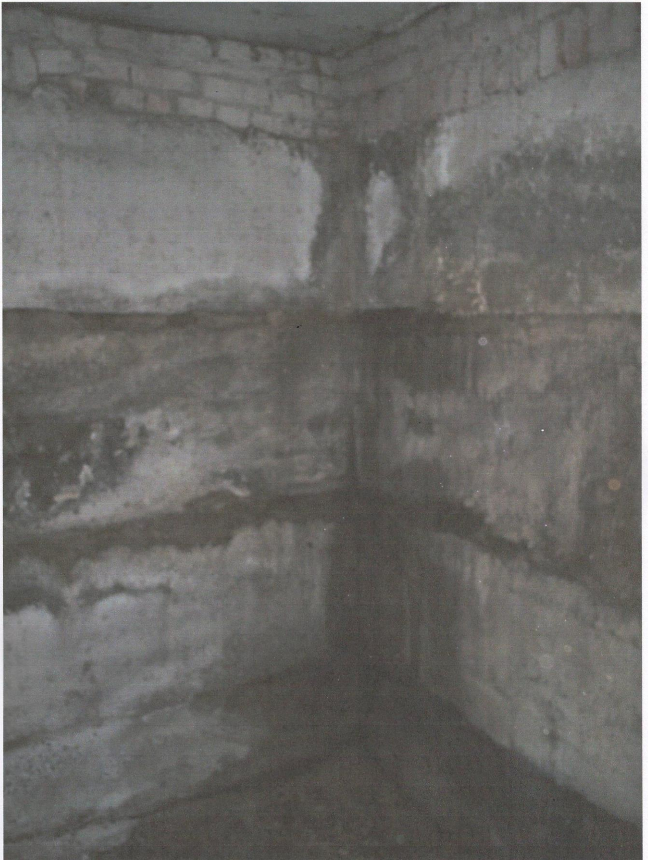
Фото А.16 – Систематичне замочування стін підвалу по осям Е-15 через тріщини між асфальтобетонною відмосткою та цоколем стіни та неправильну організацію рельєфу прилеглої території
