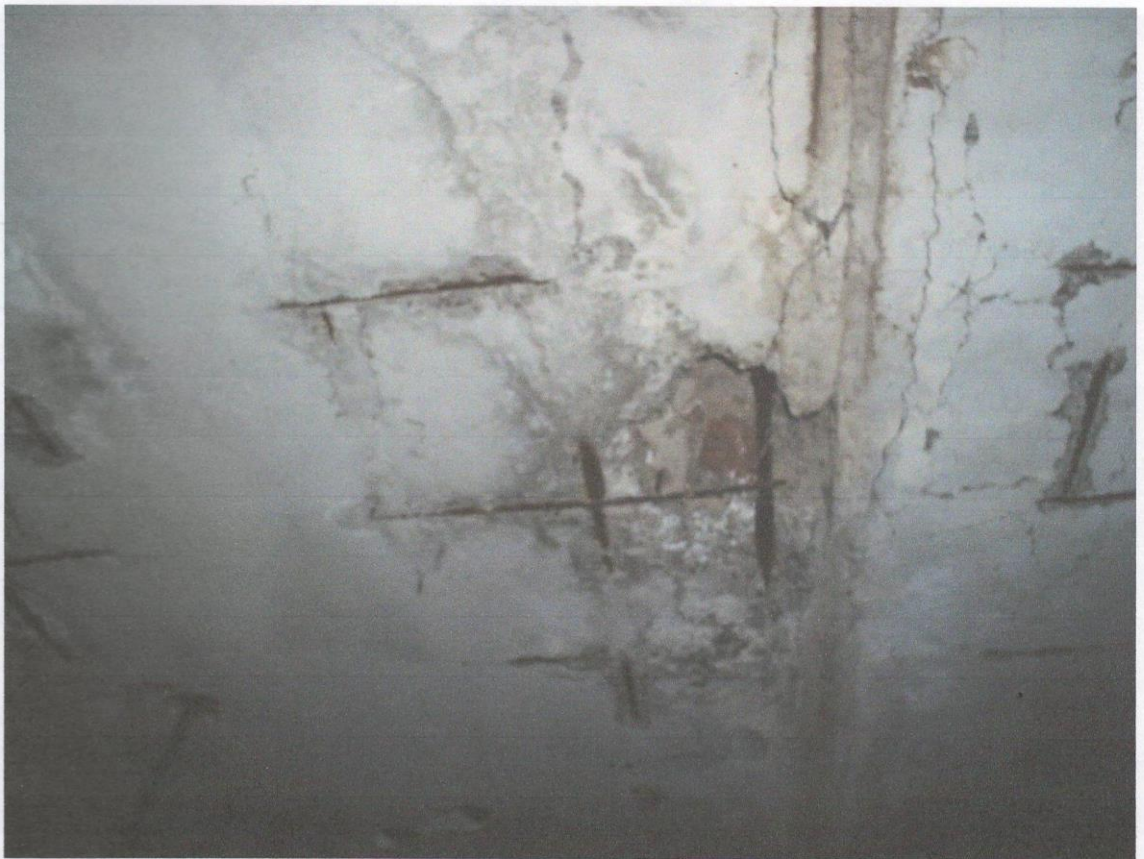
Фото А.37 - Відшарування захисного шару бетону, оголення та корозія робочої та конструктивної арматури збірних залізобетонних плит перекриття над підвалом в місцях влаштування сантехнічних комунікацій
