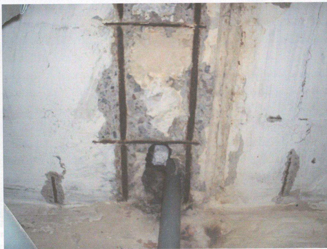
Фото А.35 – Відшарування захисного шару бетону, оголення та корозія робочої та конструктивної арматури збірних залізобетонних плит перекриття над підвалом в місцях влаштування сантехнічних комунікацій
