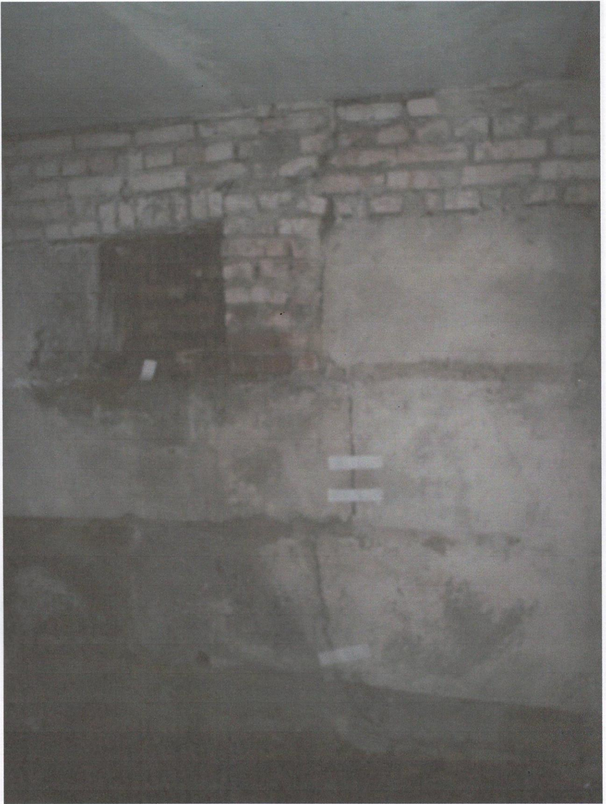
Фото А.23 – Тріщина в стіні підвалу по осі А в осях 8-11 внаслідок систематичного замочування та нерівномірних осадок ґрунтів основи фундаментів
