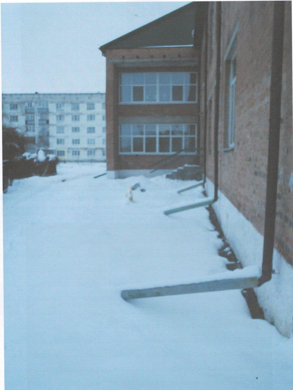
Фото А.13 – Тріщини між асфальтобетонною відмосткою та цоколем стіни по осі Б в осях 11-18, просідання відмостки в результаті замочування через недостатній виліт водостічних труб та неправильну організацію рельєфу прилеглої території
