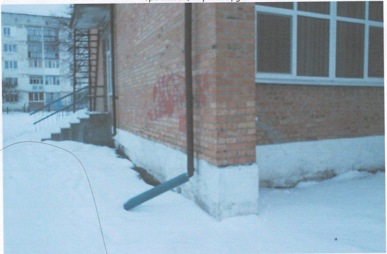
Фото А.12 – Тріщини між асфальтобетонною відмосткою та цоколем стіни в осях 11-А, просідання відмостки в результаті замочування через недостатній виліт водостічних труб та неправильну організацію рельєфу
