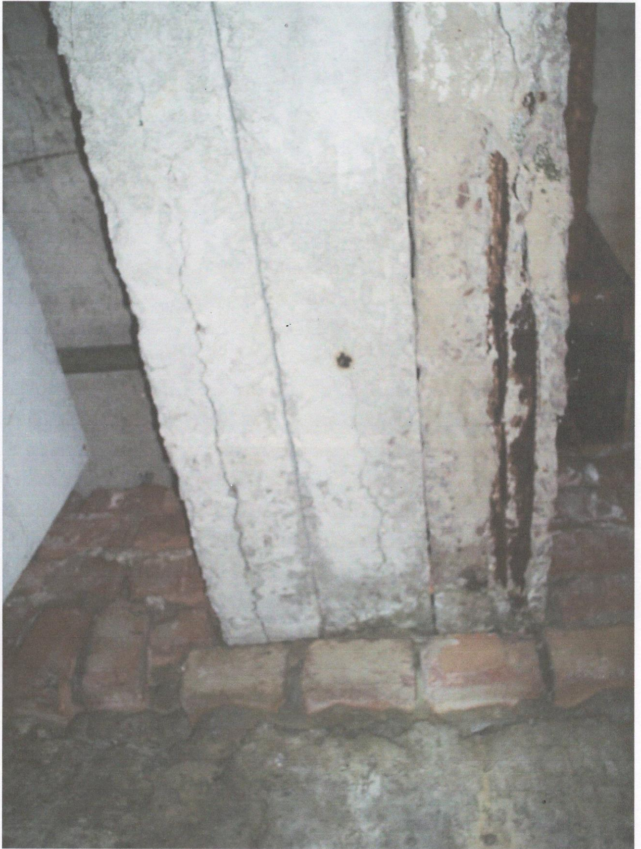
Фото А.34 – Відшарування захисного шару бетону, оголення та корозія робочої арматури перемичок стіни підвалу по осі В в осях 14-15
