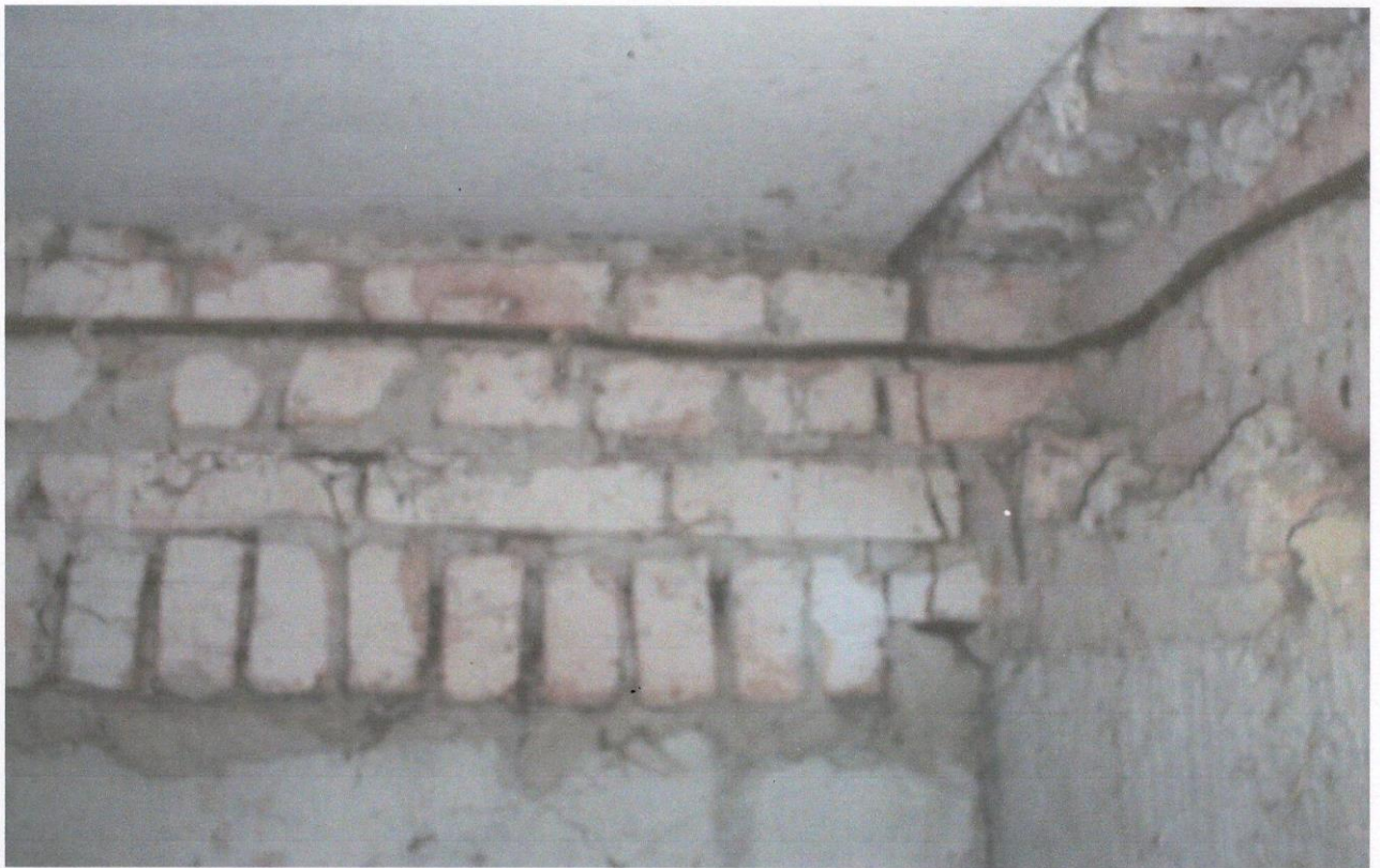
Фото А.21 – Тріщина в стіні підвалу по осям 15-Б внаслідок систематичного замочування та нерівномірних осадок ґрунтів основи фундаментів
