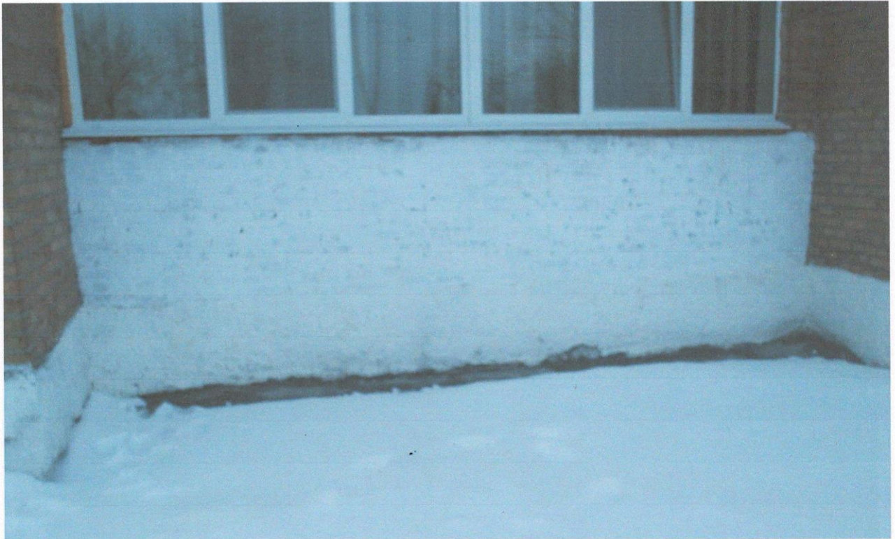
Фото А.7 – Тріщини між асфальтобетонною відмосткою та цоколем стіни по осі 11 в осях А-Б, просідання відмостки в результаті замочування через неправильну організацію рельєфу прилеглої території
