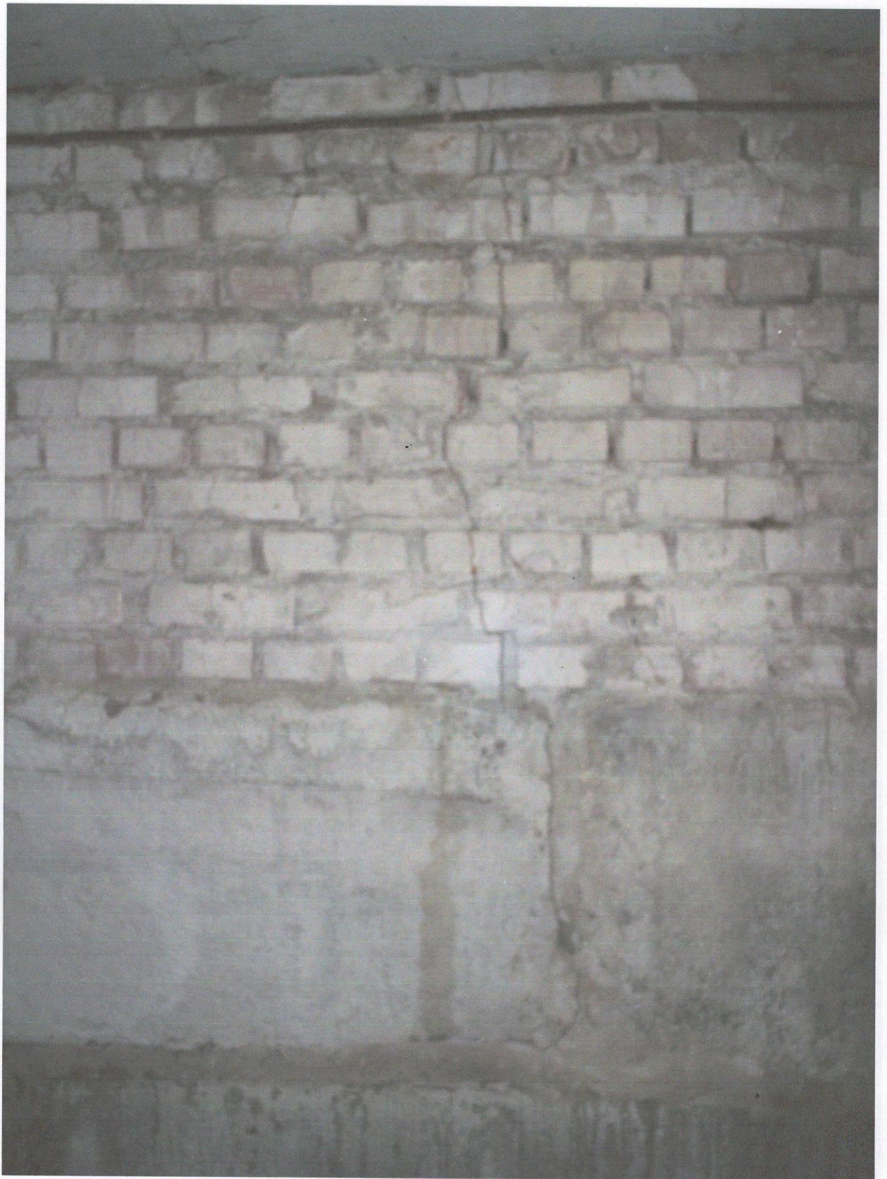
Фото А.20 – Тріщина в стіні підвалу по осі И в осях 14–15 внаслідок систематичного замочування та нерівномірних осадок ґрунтів основи фундаментів
