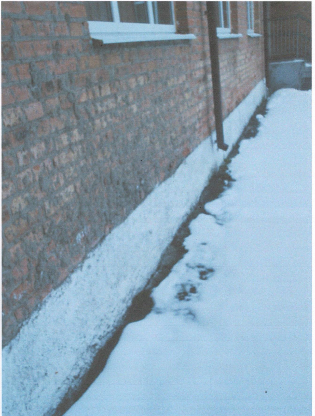
Фото А.4 – Тріщини між асфальтобетонною відмосткою та цоколем стіни по осі 15 в осях Г-Е, просідання відмостки в результаті замочування через недостатній виліт водостічних труб та неправильну організацію рельєфу
