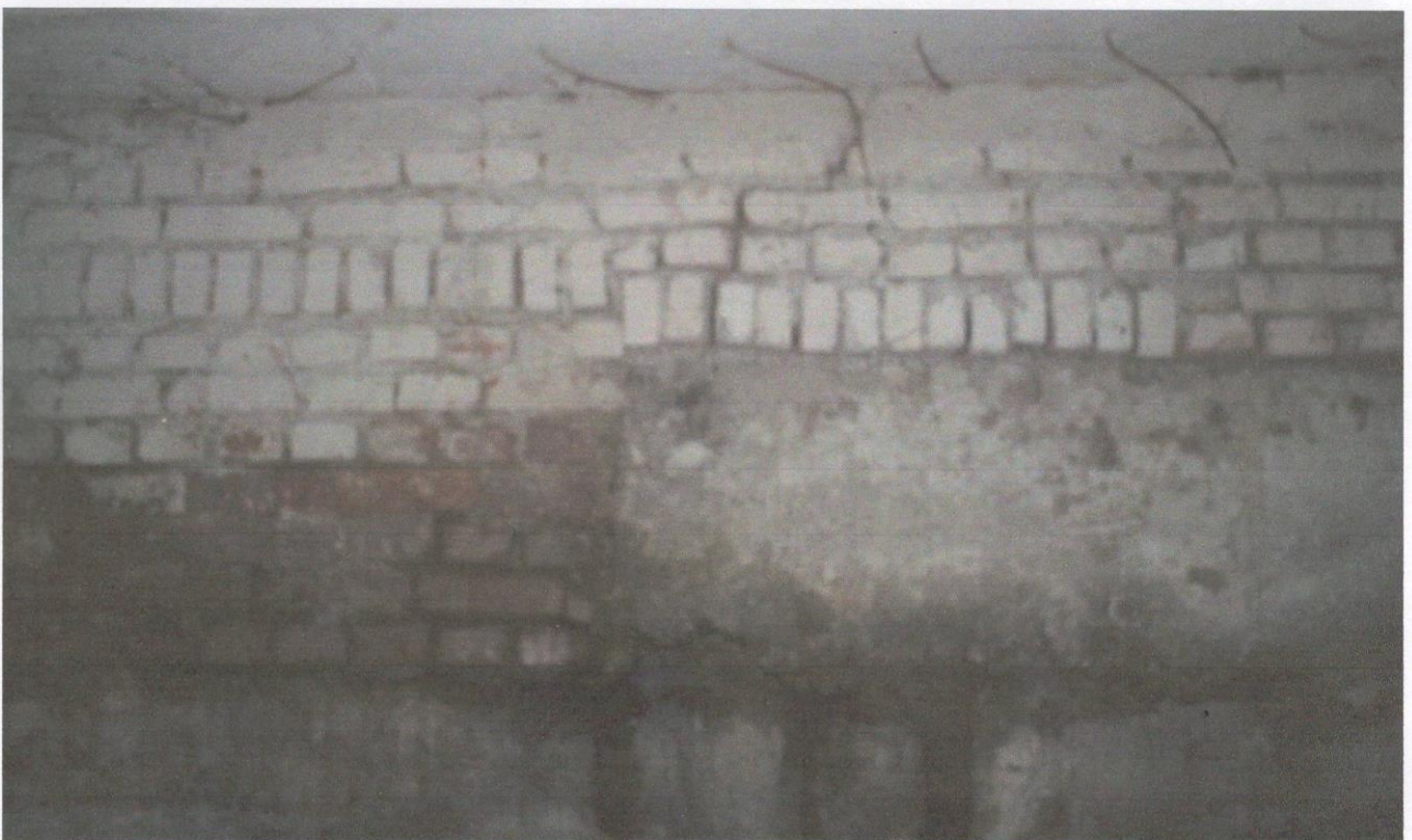
Фото А.22 – Тріщина в стіні підвалу по осі 11 в осях А-Б внаслідок систематичного замочування та нерівномірних осадок ґрунтів основи фундаментів
