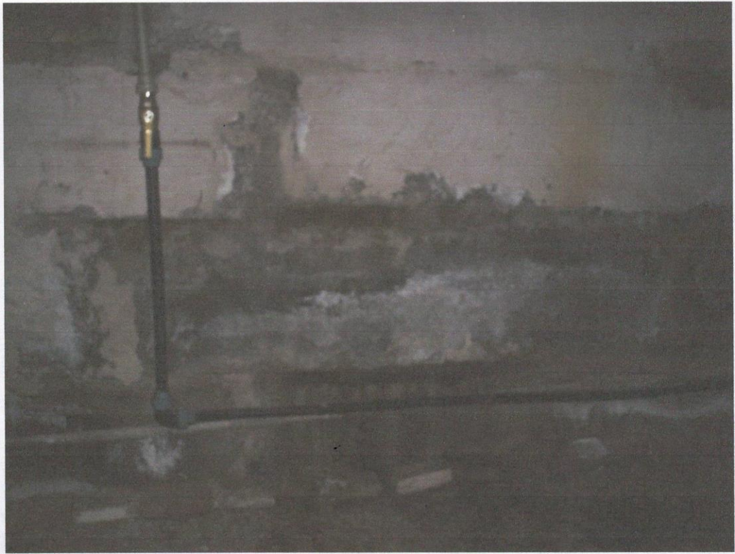
Фото А.14 – Систематичне замочування стін підвалу (по осі 7 в осях Л-И) через тріщини між асфальтобетонною відмосткою та цоколем стіни та неправильну організацію рельєфу прилеглої території
