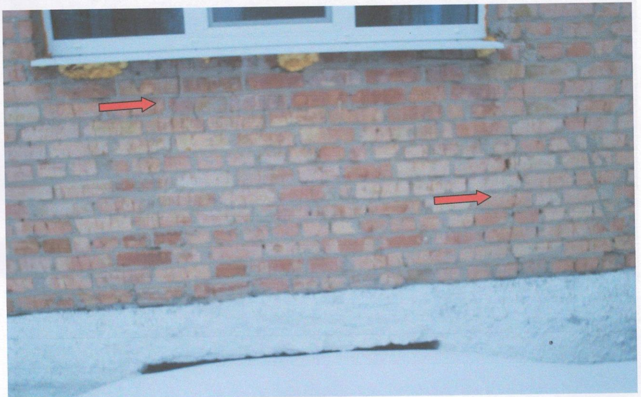
Фото А.30 - Тріщини в цегляній стіні по осі 10 в осях Г-Е внаслідок нерівномірних осадок ґрунтів основи фундаментів
