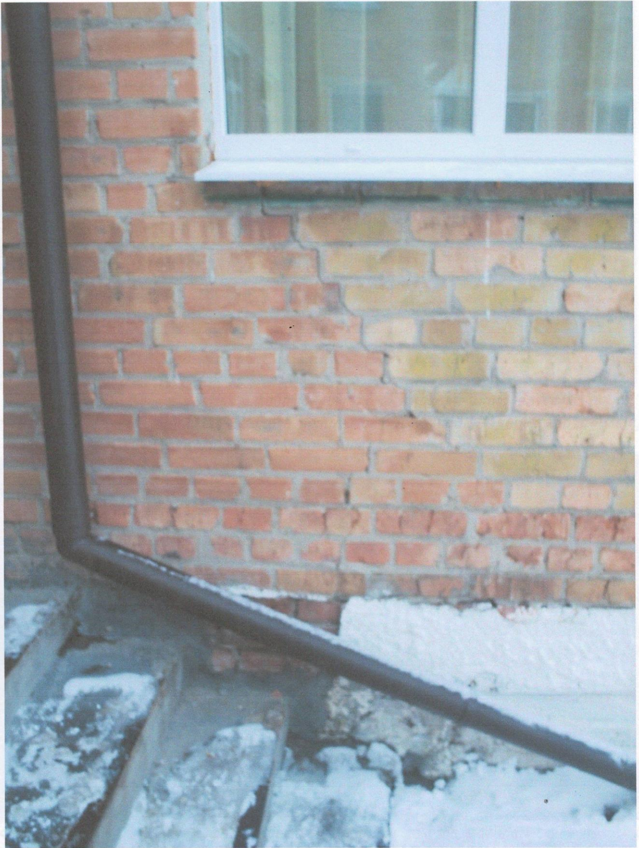
Фото А.6 – Тріщини між асфальтобетонною відмосткою та цоколем стіни по осі Є в осях 15-16, просідання відмостки в результаті замочування через неякісний монтаж водостічних труб та неправильну організацію рельєфу, що призвело до тріщин в цегляних стінах внаслідок нерівномірних деформацій ґрунтів основи
