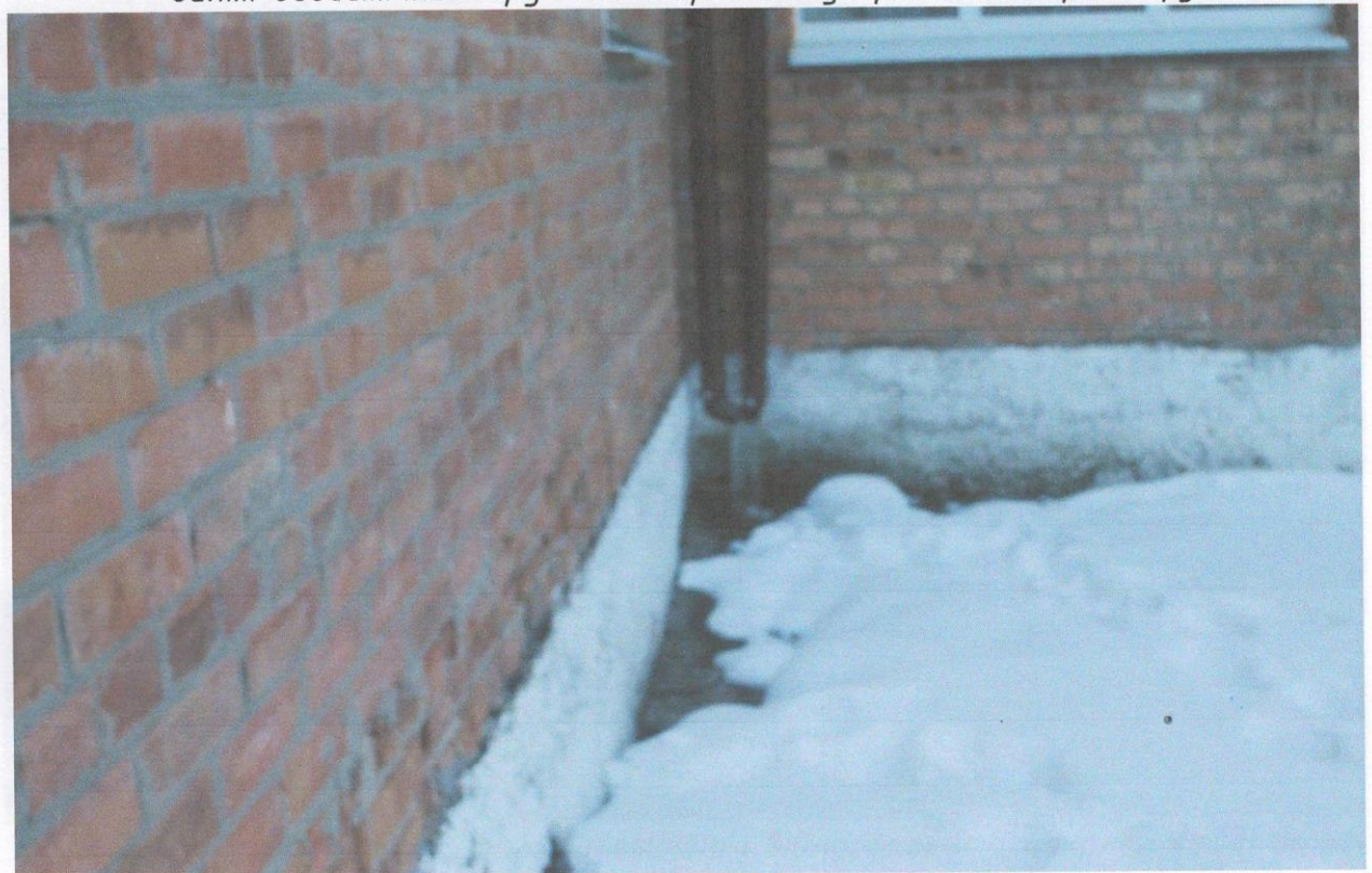
Фото А.3 – Тріщини між асфальтобетонною відмосткою та цоколем стіни по осям Г-15, просідання відмостки в результаті замочування через недостатній виліт водостічних труб та неправильну організацію рельєфу
