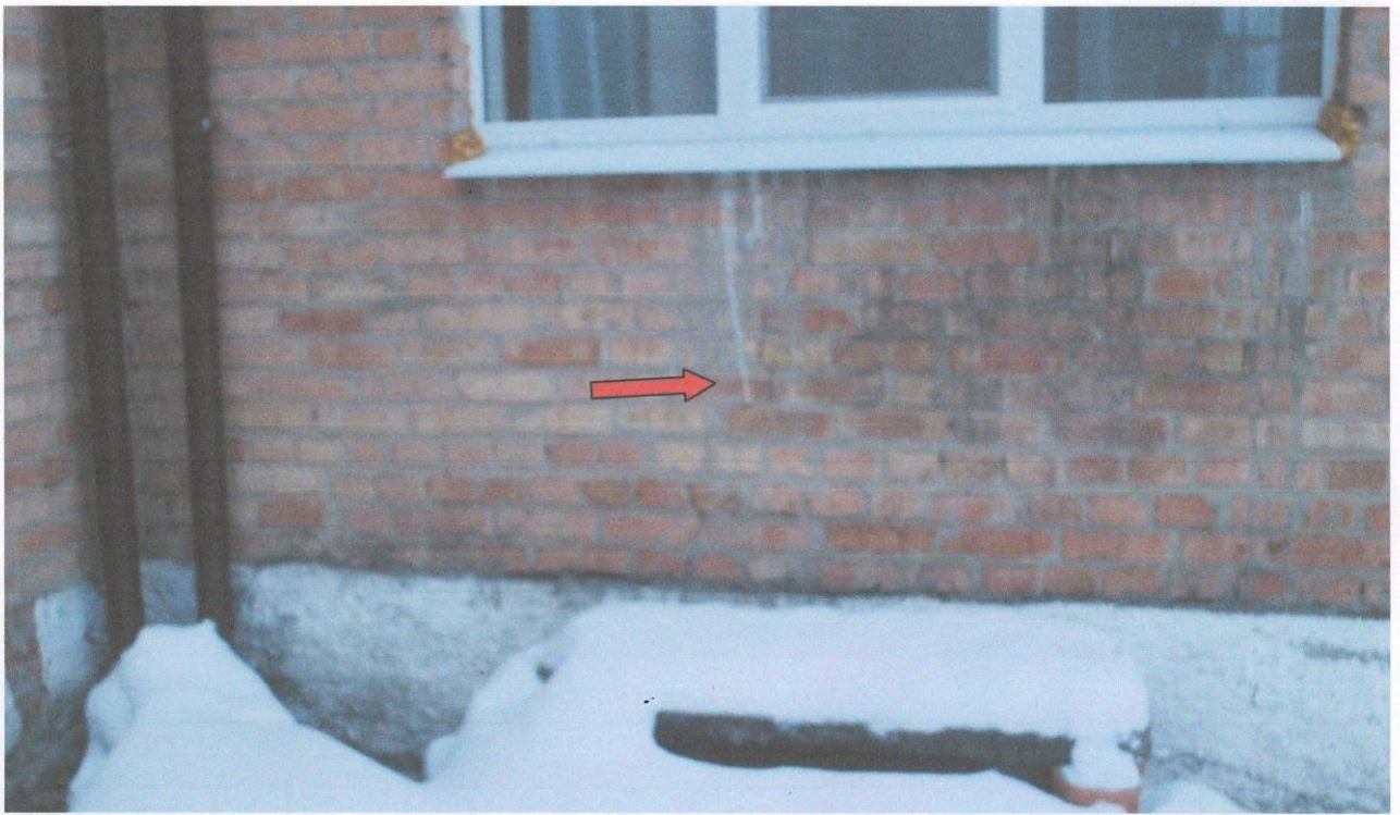
Фото А.31 – Тріщини в цегляній стіні по осі В біля осі 10 внаслідок нерівномірних осадок ґрунтів основи фундаментів через систематичне замочування
