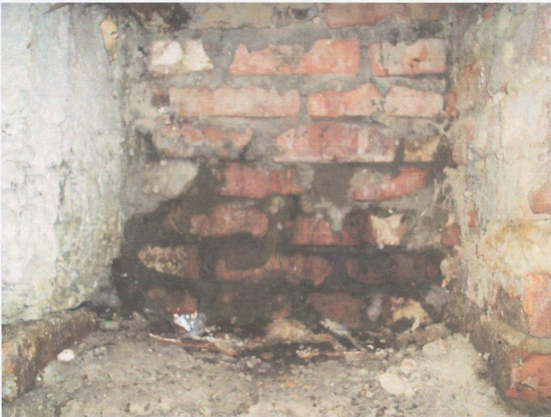
Фото А.15 – Систематичне замочування стін підвалу по осі Е в осях 15-16 через тріщини між асфальтобетонною відмосткою та цоколем стіни та неправильну організацію рельєфу прилеглої території
