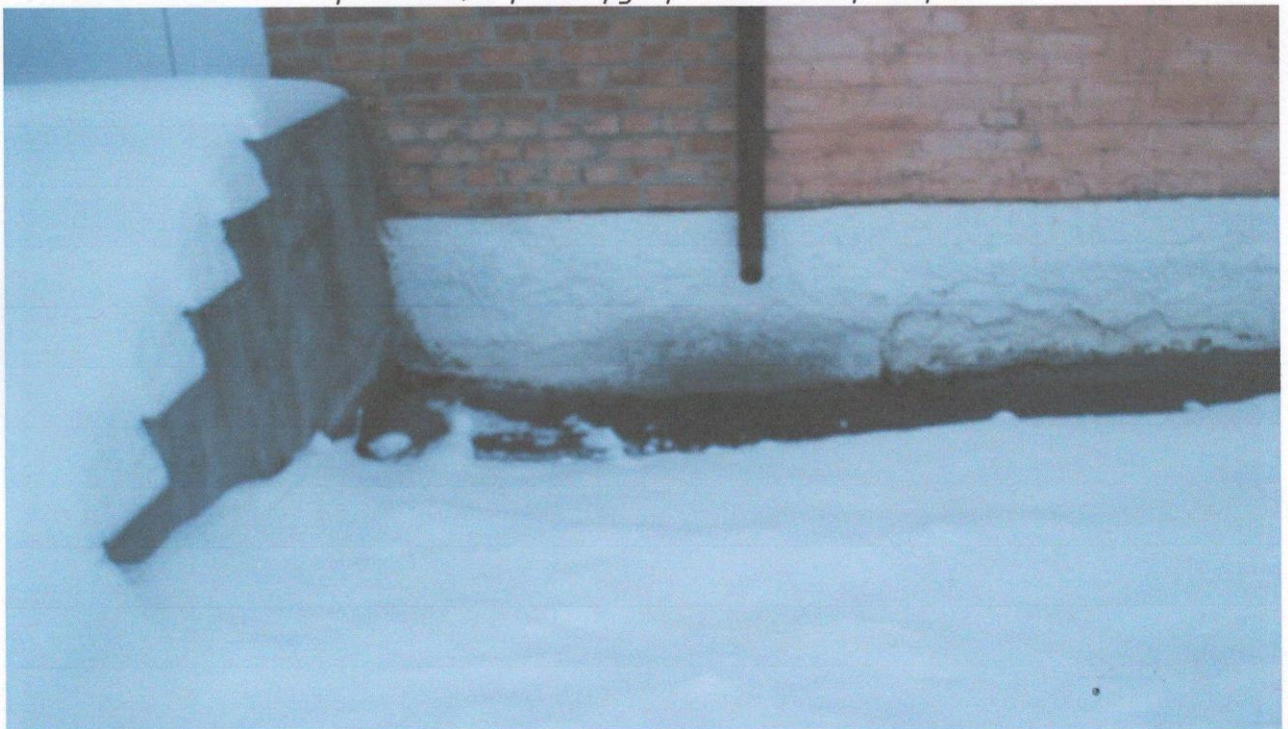
Фото А.8 – Тріщини між асфальтобетонною відмосткою та цоколем стіни по осі Д в осях 1-4, просідання відмостки в результаті замочування через недостатній виліт водостічних труб та неправильну організацію рельєфу
