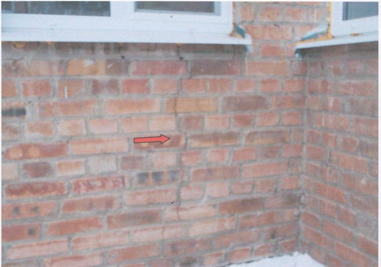
Фото А.28 – Тріщини в цегляній стіні по осі 14 біля осі И внаслідок нерівномірних осадок ґрунтів основи фундаментів через систематичне замочування
