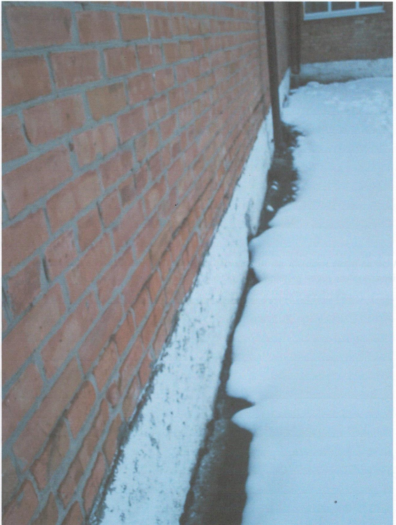
Фото А.1 – Тріщини між асфальтобетонною відмосткою та цоколем стіни по осі Г в осях 18-15, просідання відмостки в результаті замочування через недостатній виліт водостічних труб та неправильну організацію рельєфу
