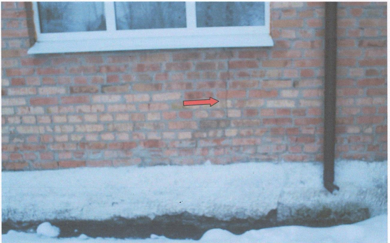
Фото А.26 – Тріщини в цегляній стіні по осі 15 в осях Г-Е внаслідок нерівномірних осадок ґрунтів основи фундаментів через систематичне замочування
