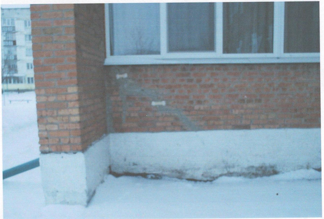
Фото А.33 - тріщини в цегляній стіні по осі 11 в осях А-Б внаслідок нерівномірних осадок ґрунтів основи фундаментів
