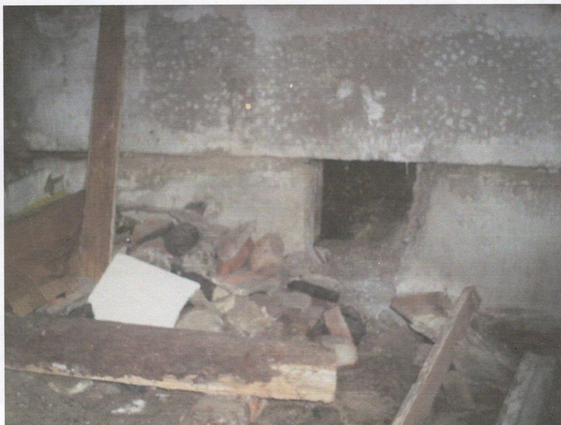
Фото А.19 – Систематичне замочування стін підвалу по осі Г в осях 15-16 через тріщини між асфальтобетонною відмосткою та цоколем стіни та неправильну організацію рельєфу прилеглої території
