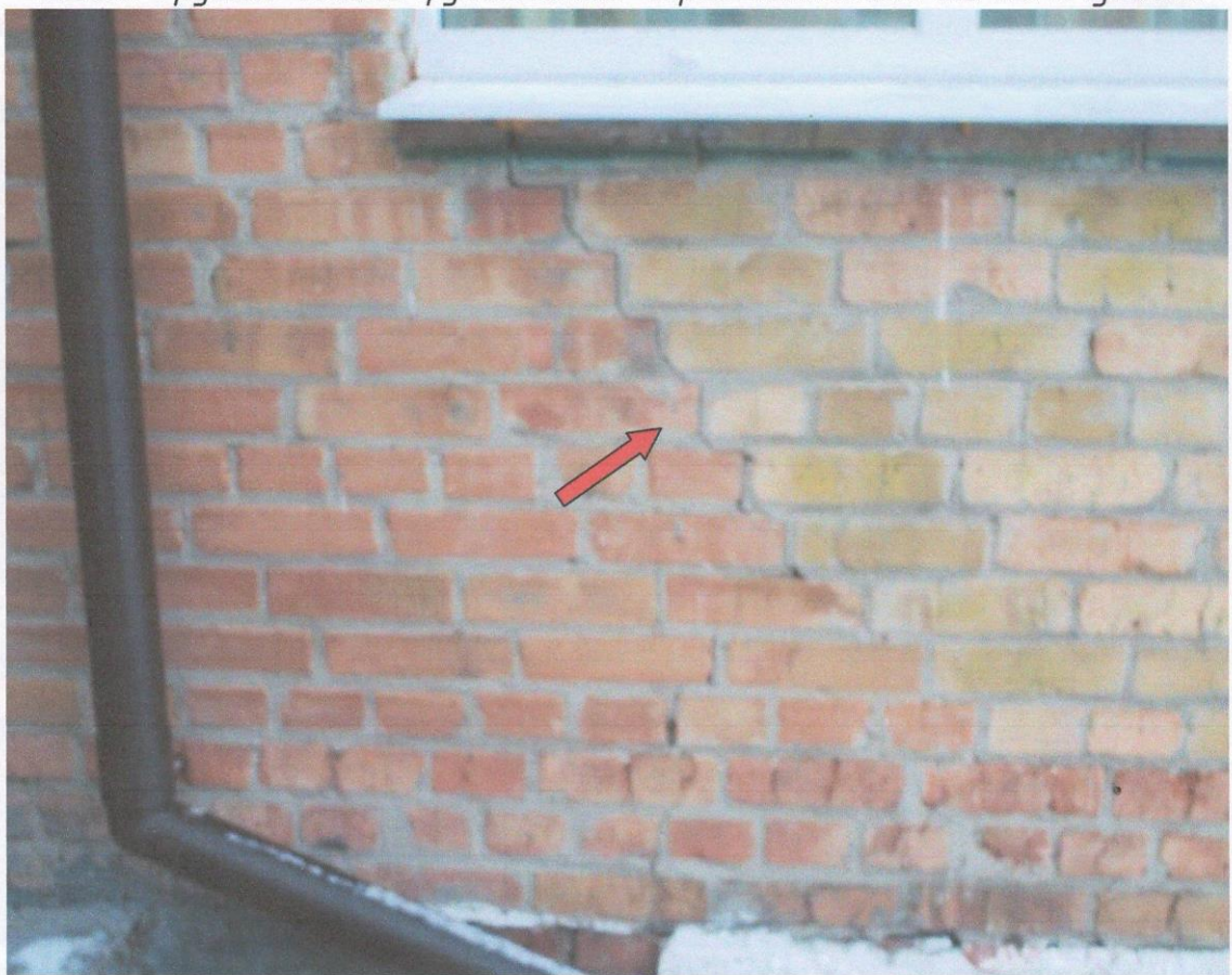
Фото А.27 – Тріщини в цегляній стіні по осі Е в осях 15-16 внаслідок нерівномірних осадок ґрунтів основи фундаментів
