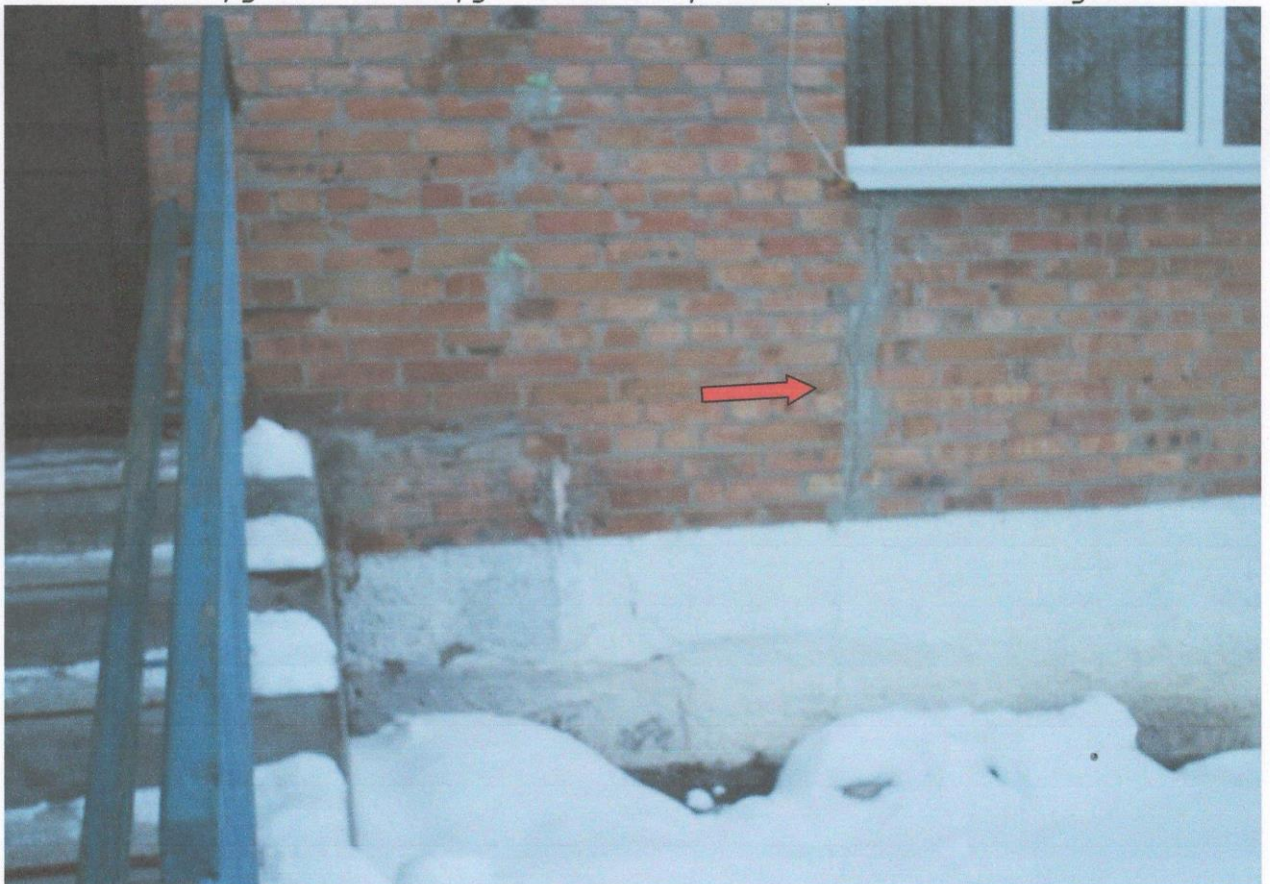
Фото А.32 – Тріщини в цегляній стіні по осі Б в осях 13-15 внаслідок нерівномірних осадок ґрунтів основи фундаментів
