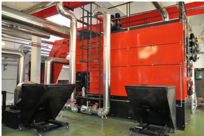
Рис. 28. Котельне обладнання Крігер
