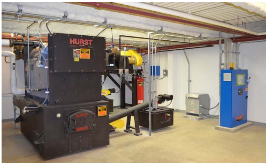
Рис. 25. Котельне обладнання Hurst Boiler
