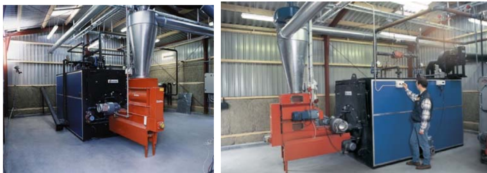
Рис. 45. Котел та система подачі біопалива
