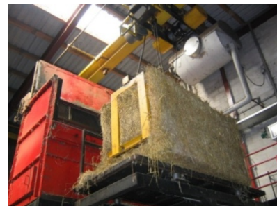
Рис. 60. Мостовий кран на оперативному складі палива котельні
